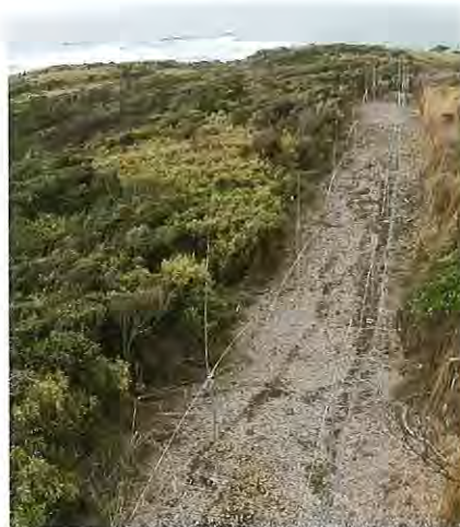
長崎県対馬に設置した短波海洋レーダの受信アンテナ列
